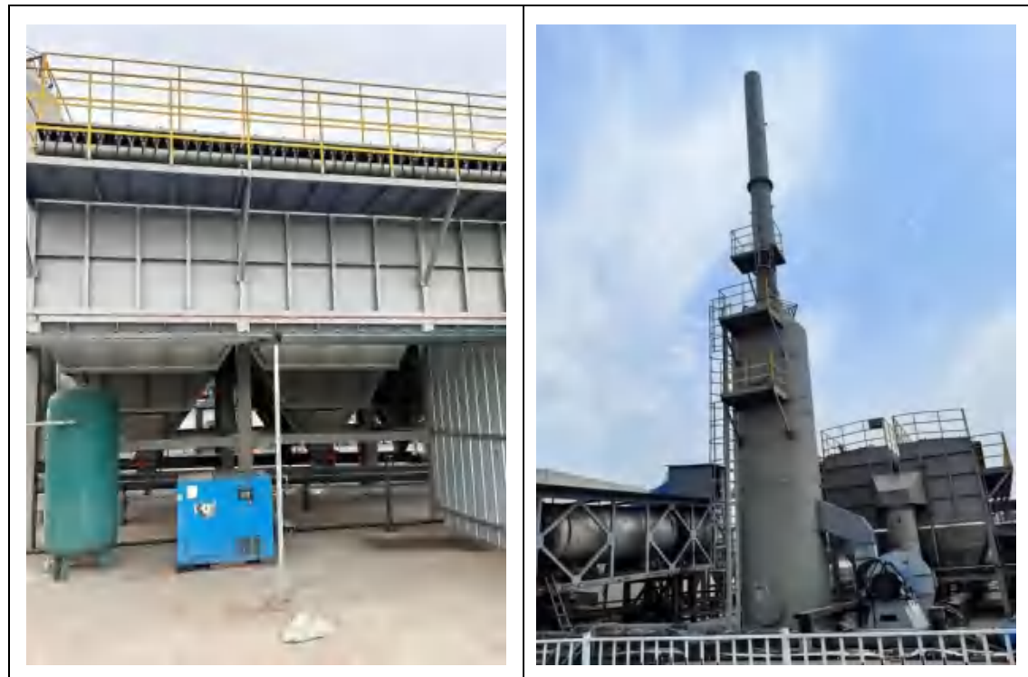
图 3.9-12 热脱附设施烟气净化系统
