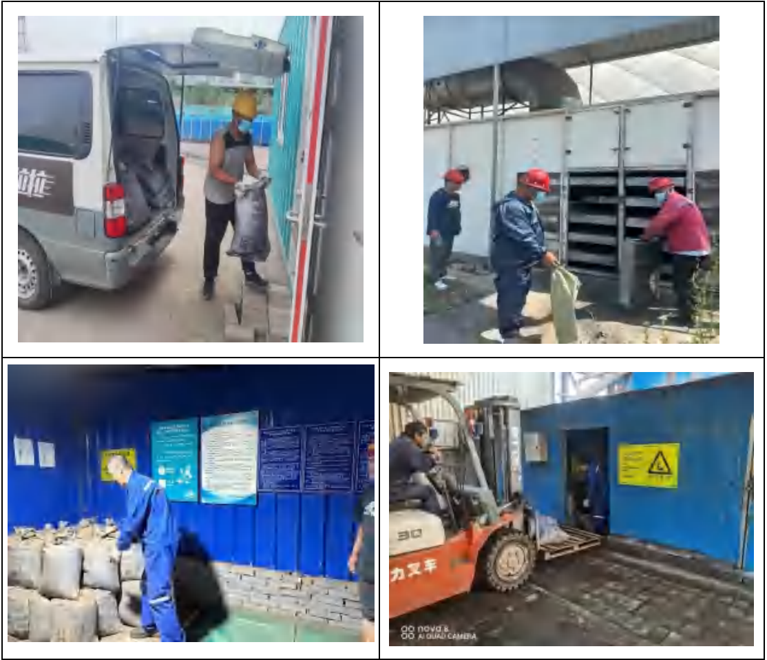
图 3.9-19 活性炭购置入场、更换及外运处置
