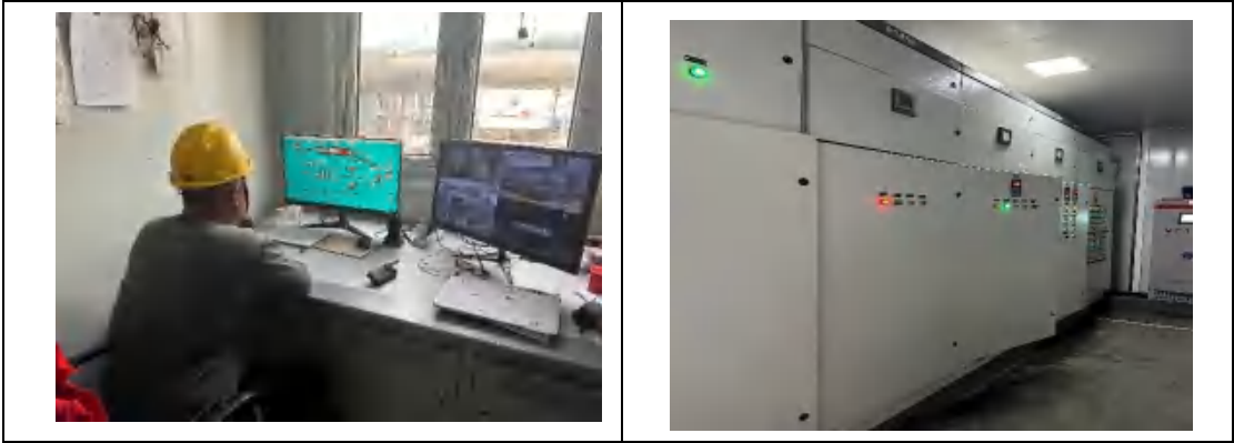
图 3.6-10 热脱附设备及运行实景
