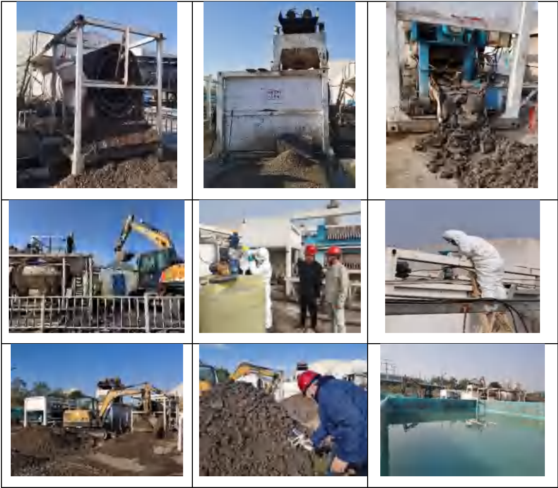
图 3.6-15 化学淋洗设备及运行实景
