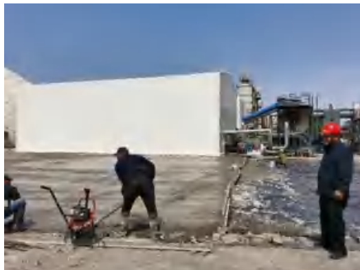
图 3.9-26 淋洗成品土待检区防渗措施
