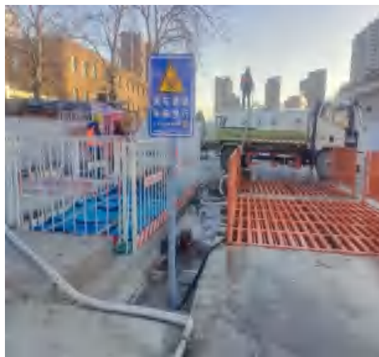
图 3.9-17 洗车池废水收集清理
